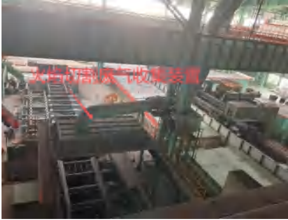
火焰切割废气收集装置
