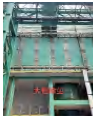
P4 连铸废气、钢包维修废气、火焰切割废气、上料废气袋式除尘器
