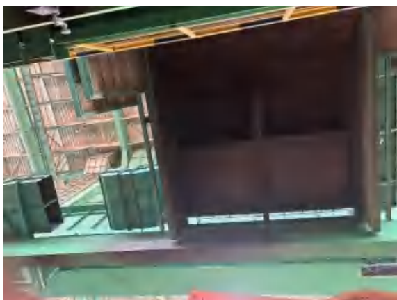
连铸废气收集装置（俯拍）
